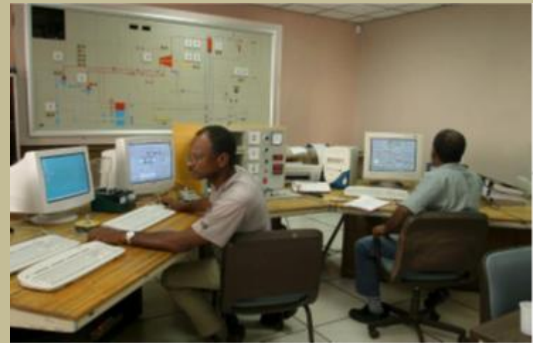
Salle de contrôle-commande, Bouillante,(CFG Services)
