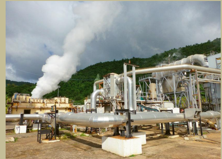
Centrale géothermique de Bouillante (Guadeloupe)
