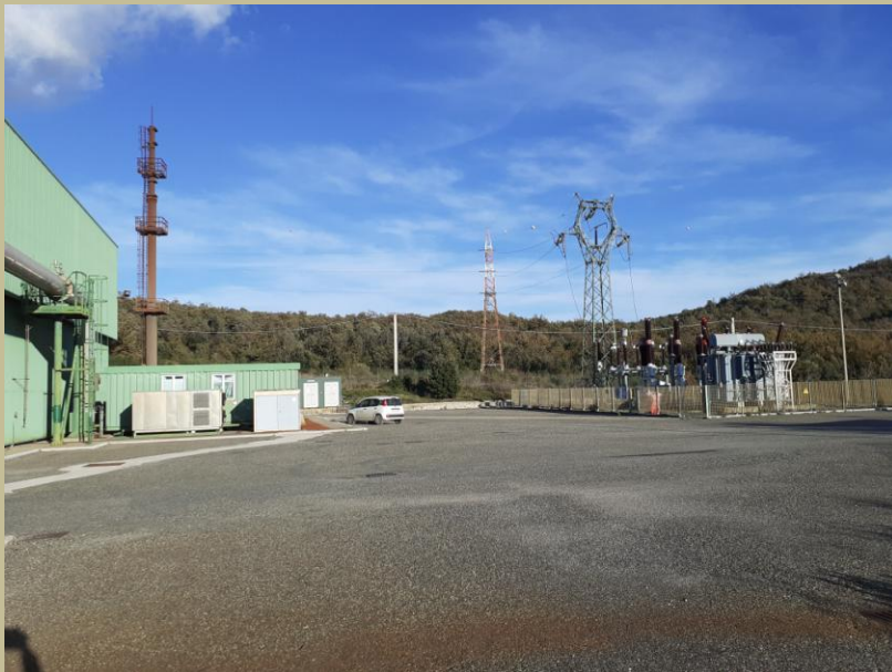
Transformateur Monteverdi Maritimo, Toscane
