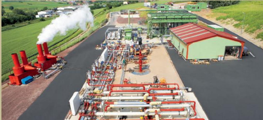
Site laboratoire passé au stade industriel de Soutz-sous-Forêts (Alsace)
