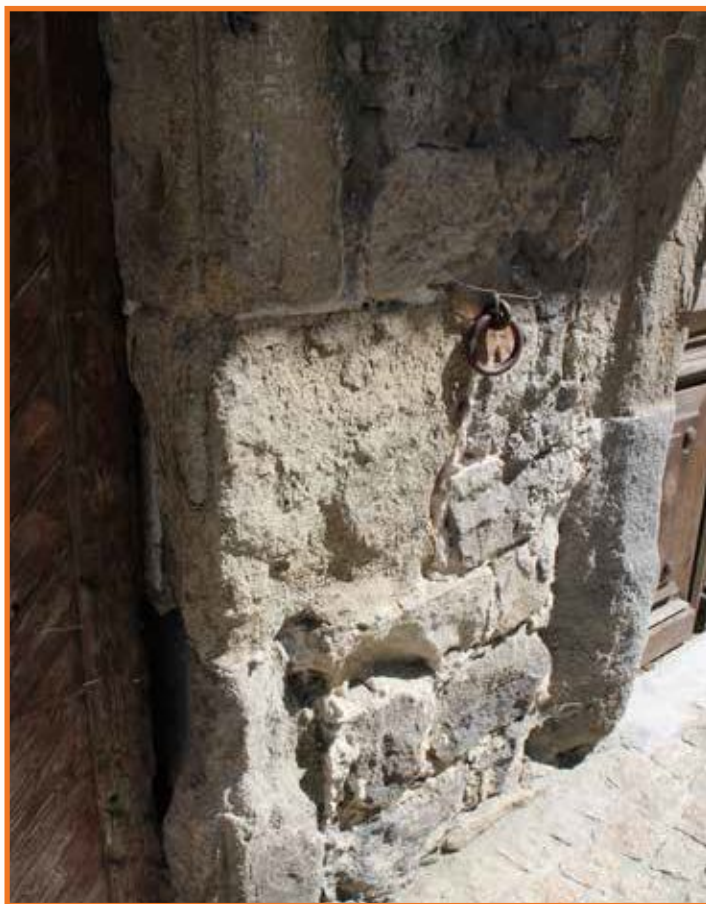
Photo 12 : Un aspect de la dégradation des grès et conglomérats carbonifères dans l'encadrement d'une baie d'une maison longeant la place Saint Bonnet.
